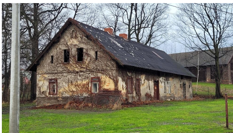
fot. 11 Łąka, ul. Turystyczna 34
