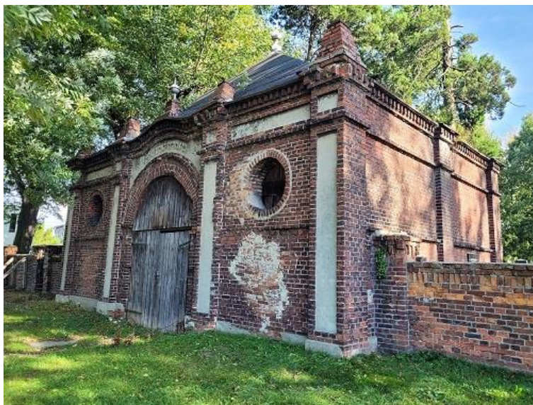
fot. 144 Pszczyna ul. Katowicka
